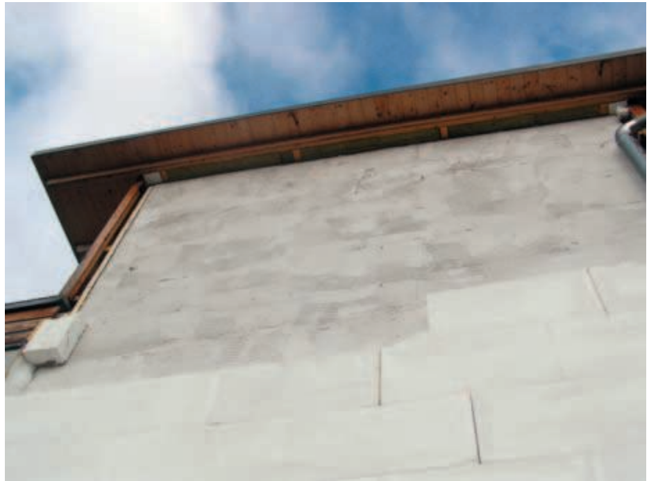
Wird die vorgeschriebene Klebekontaktfläche unterschritten, sind Schäden vorprogrammiert.
