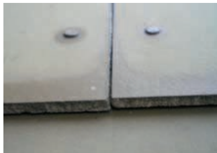
Kanten sollten allseitig zweifach beschichtet werden, um zu verhindern, dass Feuchtigkeit eindringt, die zu Schäden führen kann. Da diese Vorgehensweise bei bestehenden Platten in der Praxis oft nicht möglich ist, sollten hier auf jeden Fall schriftliche Bedenken angemeldet werden, um Regressansprüche im Nachhinein zu vermeiden.
