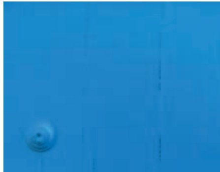
Bei einer deckenden Beschichtung sind die Furnier- risse störender sichtbar als bei einer lasierten Furnierschichtholzplatte – zumindest aus betrach- tungsüblichem Abstand an einer Fassade von ca. fünf Metern. Deckende Beschichtungen sind schon allein deshalb nicht empfehlenswert ...
