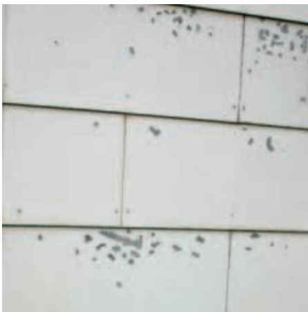
Beschädigte Platten können nicht beschichtet werden und sind gegen beschichtungsfähige, asbestfreie Platten auszutauschen.
